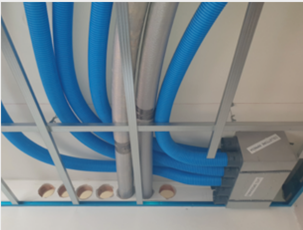
Tubazioni aerauliche e collettore VMC.
