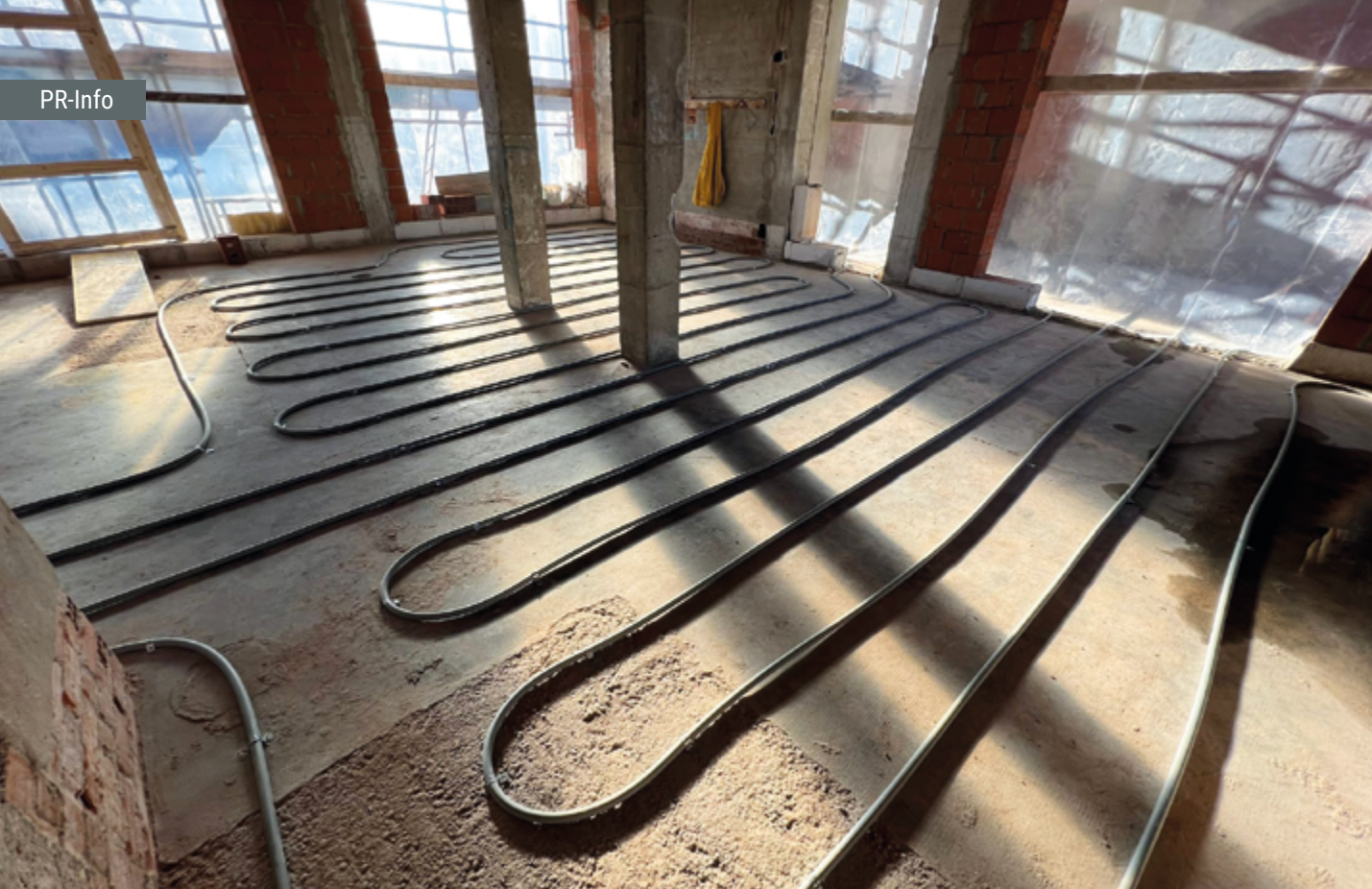
Tubazione geotermica posata internamente all'edificio.
