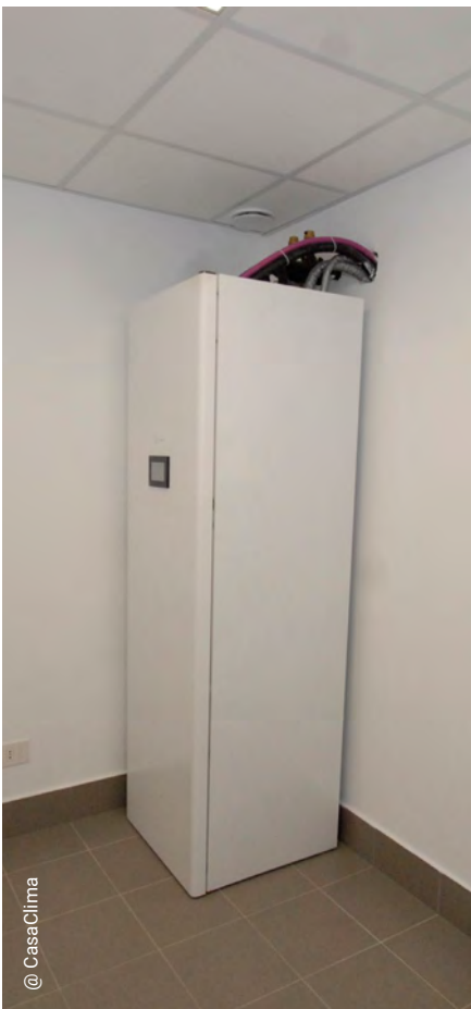
Foto 6 - Unità interna pompa di calore
