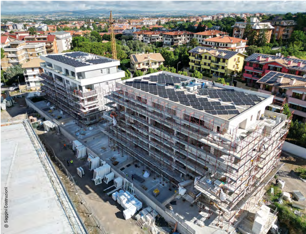
Foto 9 – Disposizione dell'impianto fotovoltaico sulla copertura dell'edificio
