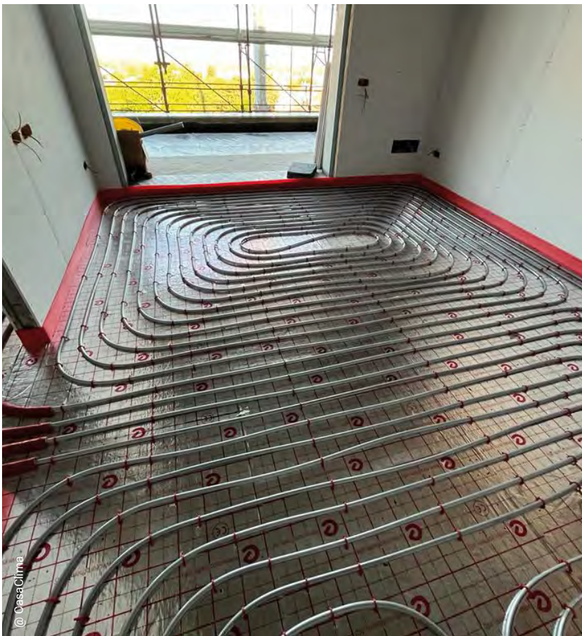
Foto 7 - Sistema di emissione con pannelli radianti a pavimento per riscaldamento e raffrescamento
