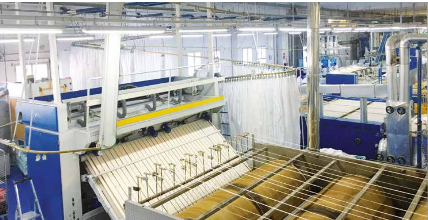
Il processo di una lavanderia industriale
