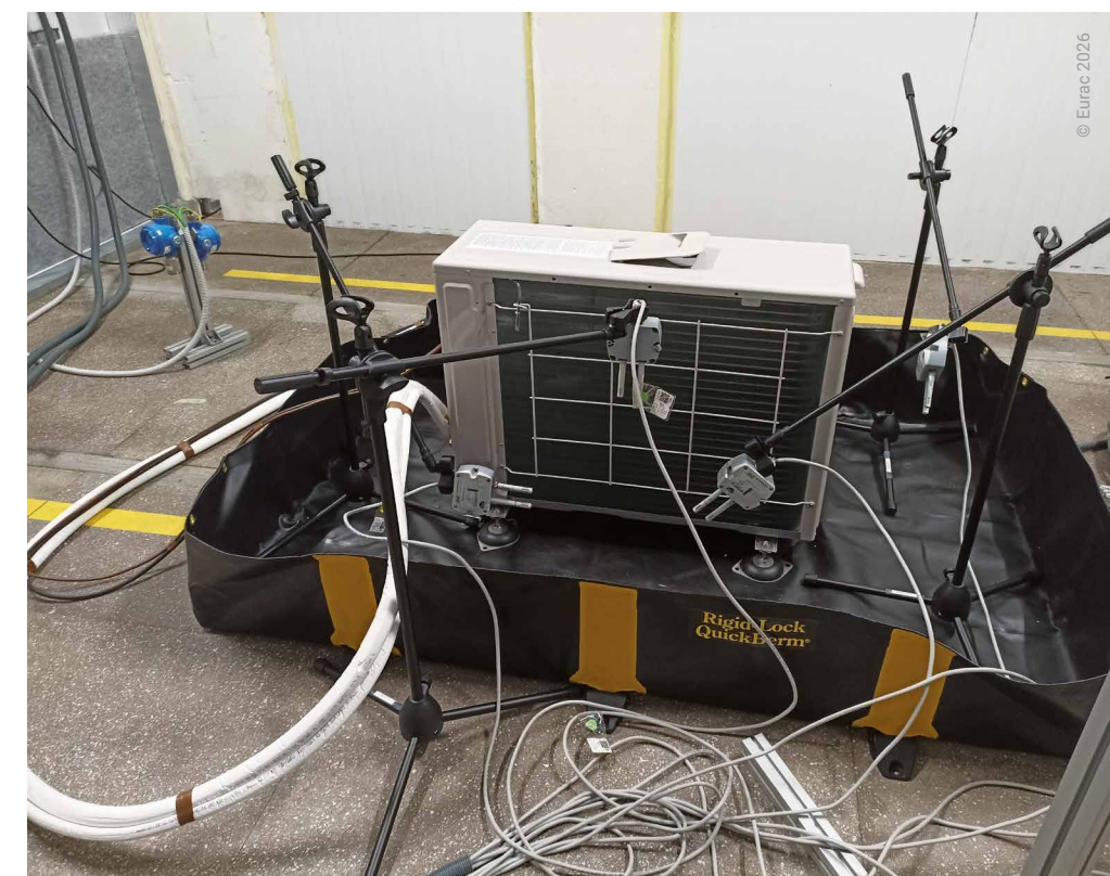
Pompa di calore installata in camera climatica nel laboratorio HPL di Eurac
